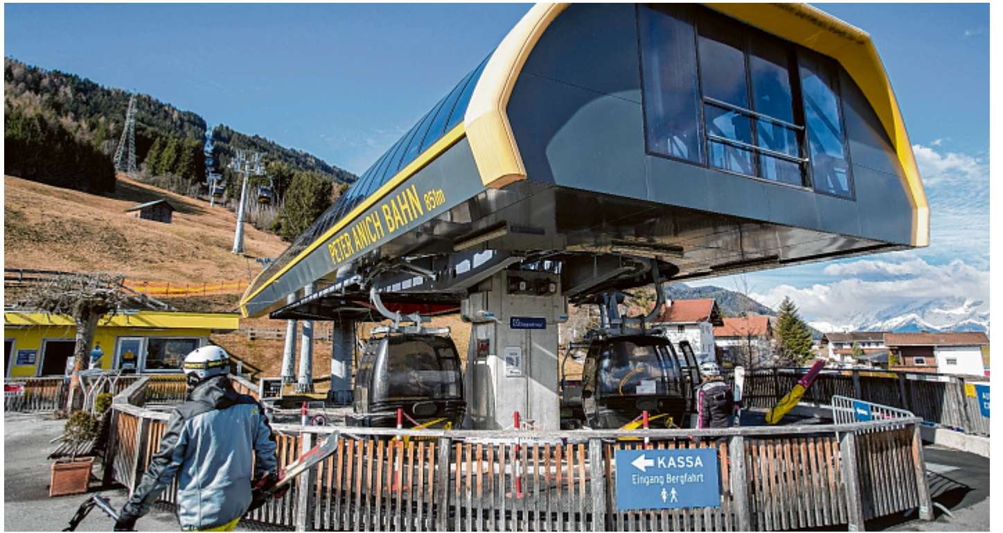
Die Skisaison am Rangger Köpfl geht dem Ende zu – für die Lifterneuerung in Sektion zwei folgen die entscheidenden Wochen aber erst. Foto: De Moor
